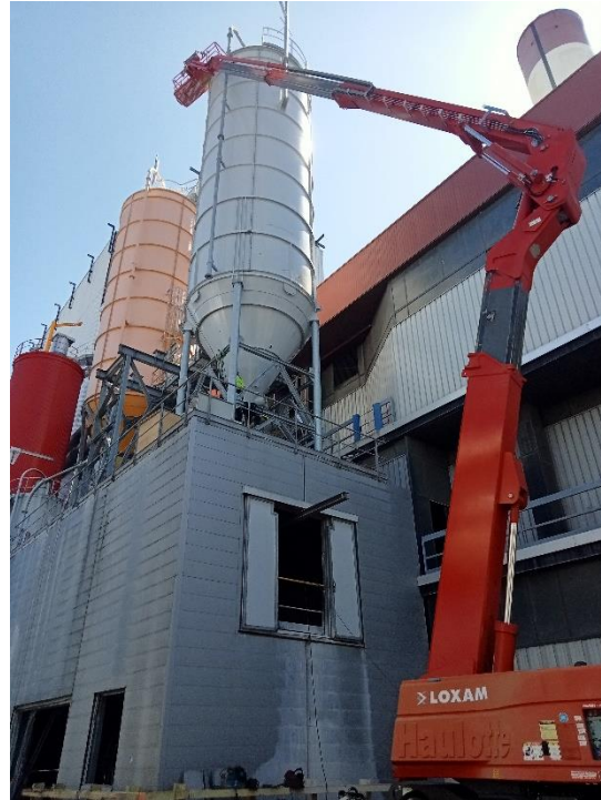
Nouveau silo de bicarbonate
